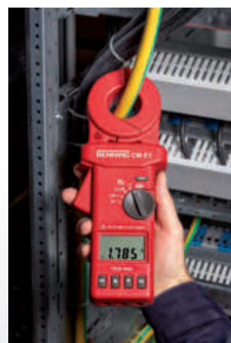
Messung des Betriebserders einer Industrieverteilung
