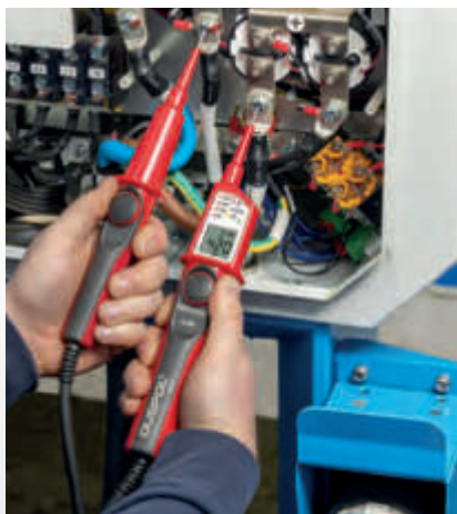
Prüfung der Ausgangsspannung einer DC-Ladeeinrichtung
